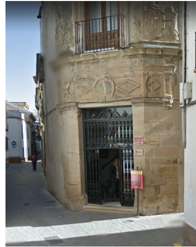
Cableado en la fachada del Palacio
