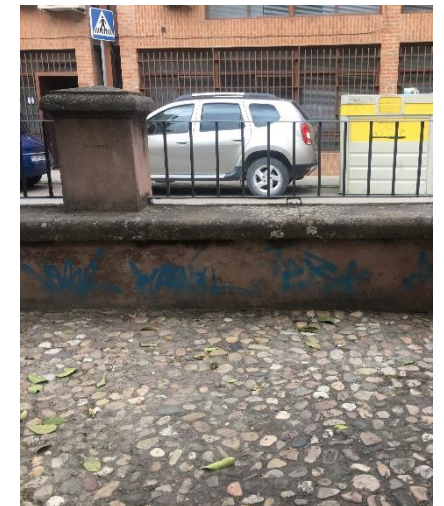
Pintadas en la bancada lateral
