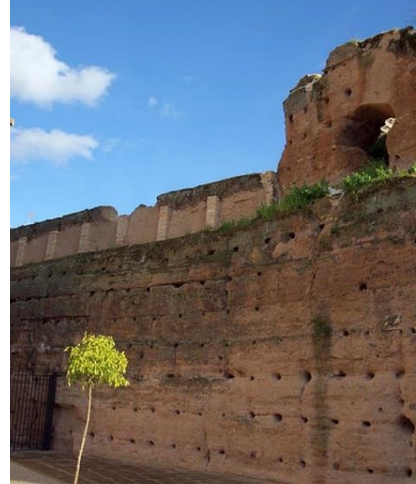
Estado de la muralla en las inmediaciones del Palacio
